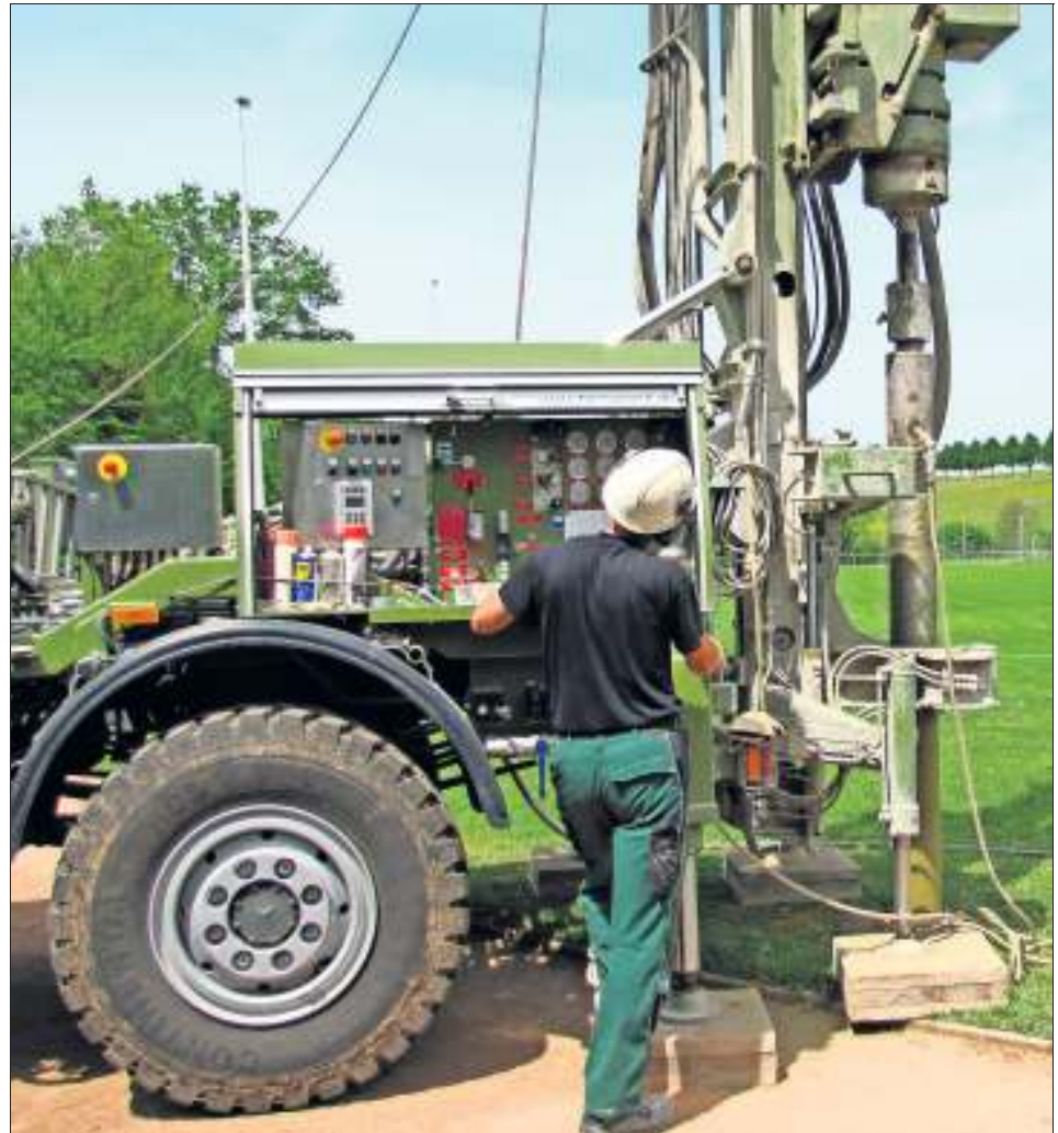
Auf dem Gelände des Hasenhofes sind derzeit Baugeräte im Einsatz, mit denen der Boden auf Schadstoffe untersucht wird.
